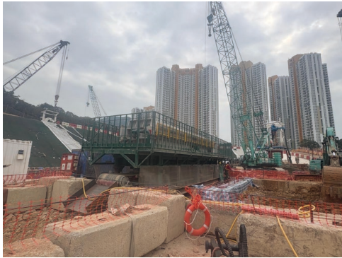
施工現場安裝的污泥脫水系統
